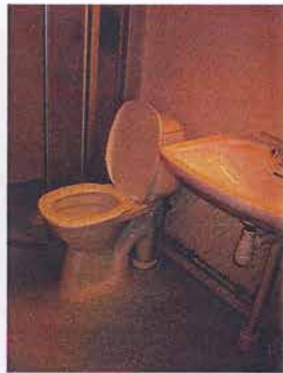
写真22 シャワー・便器・洗面
