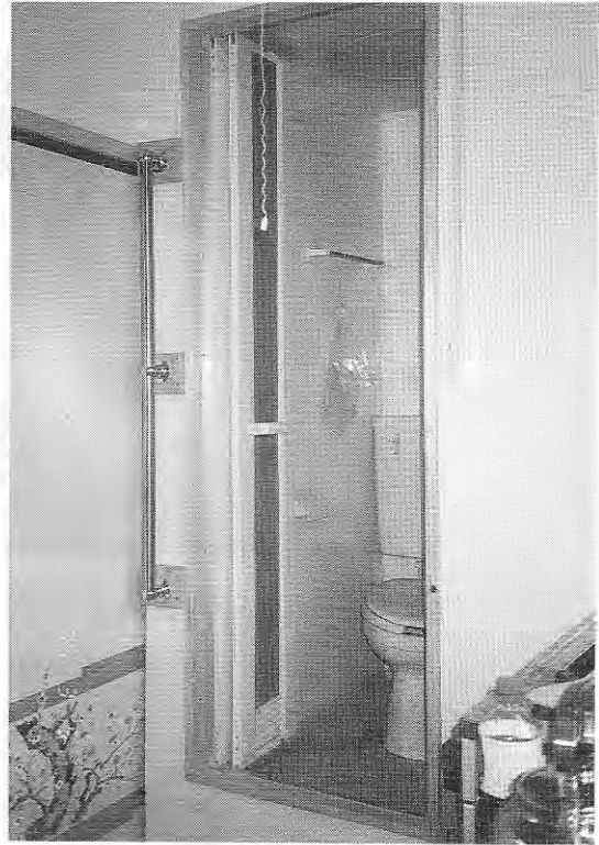
手すり：ステンレスのもので改善（補強必要） (B-3)
