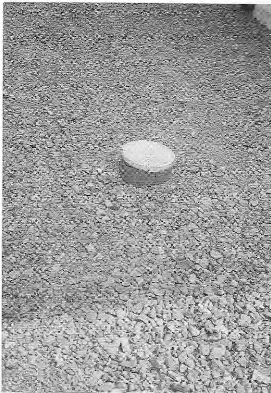
排水枡：高さが地面と揃わず、危険 (A-18)
