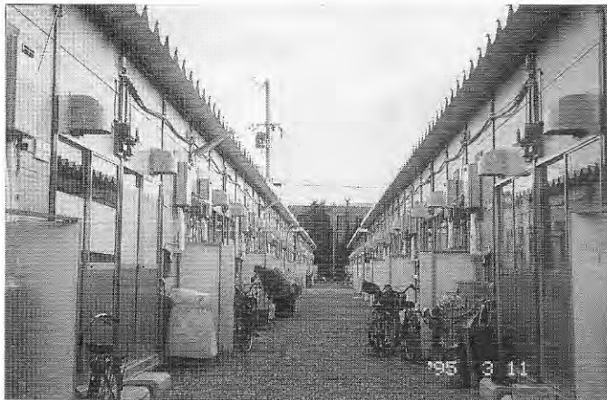
玄関：玄関灯がなく、夜は鍵穴が判らない。庇がなく、雨の日に困る (A-8)
