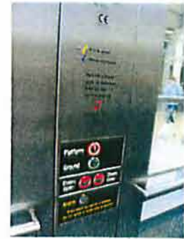
図 10.3 エレベーター操作ボタン セント・パンクラス駅
