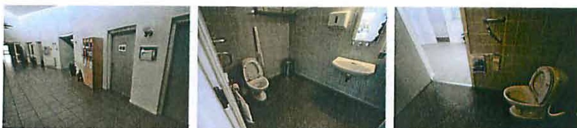
図 21.16・18 カフェテラスでの昼食に立ち寄った、グリブスコウ市の高齢者ケアセンターのトイレ エントランスまわりの廊下を広げるため、台形の平面になっている
